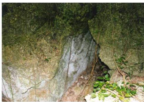
巨大転石が左右にあって傾斜面の崩落・欠壊を防止保護している (2018.12)
